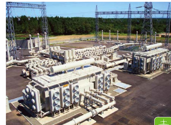
変電所 / 変電所全景
