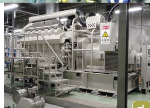
製造工場 / ディーゼル発電機
