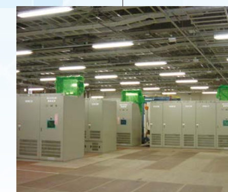
電源電磁石サイリスタ盤
