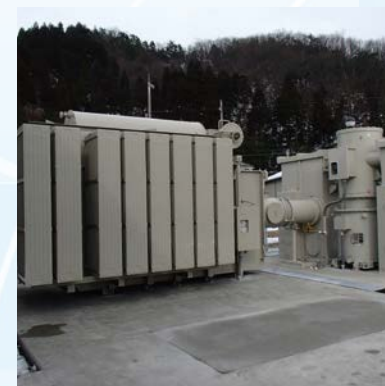
特高受変電設備
