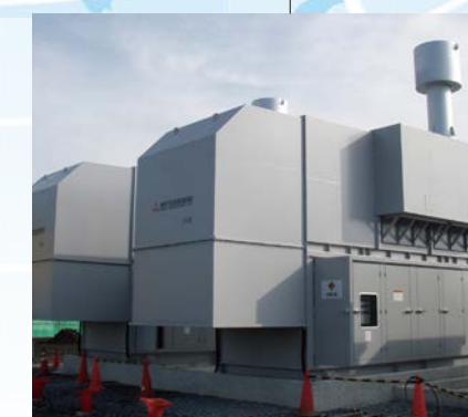
6,000kVA 非常用発電機
